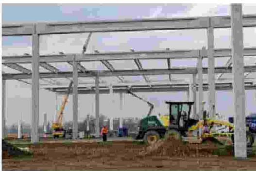
La costruzione della piattaforma di logistica di Number1 a Paullo lungo la TEEM .
