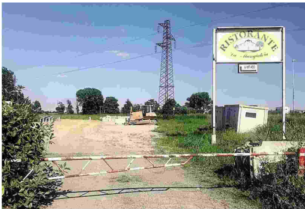
L'area del cantiere insediato per procedere alla rimozione e spostamento delle linee ad alta tensione
